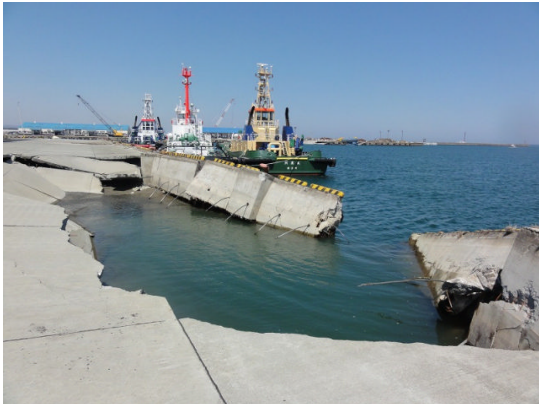
写真 2. 3. 26 相馬港 1号埠頭における鋼矢板岸壁の破損・洗掘状況
