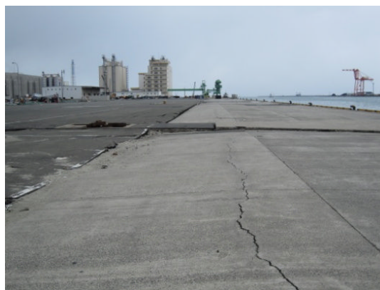
写真 2. 3. 33 中野埠頭での緩傾斜状況
