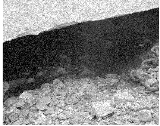
写真 2.3.6 諏訪下地区栈橋(-7.5m) —舗装下の空洞—
