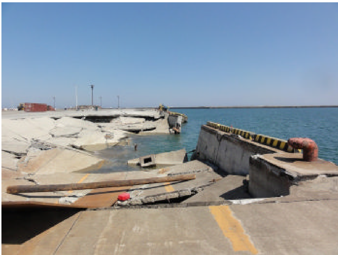
写真 2. 3. 27 相馬港 2号埠頭 鋼矢板岸壁の開口と裏埋土流失
