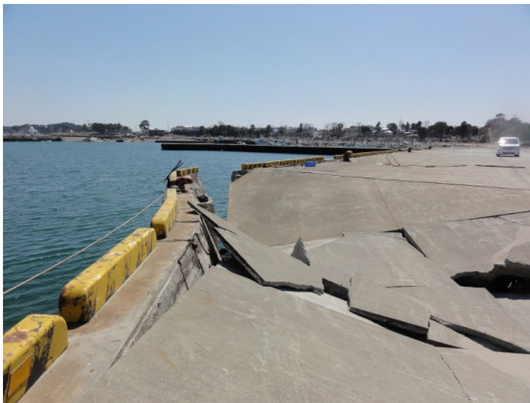
写真 2. 3. 25 相馬港 1号埠頭における鋼矢板岸壁の隅角部破損状況
