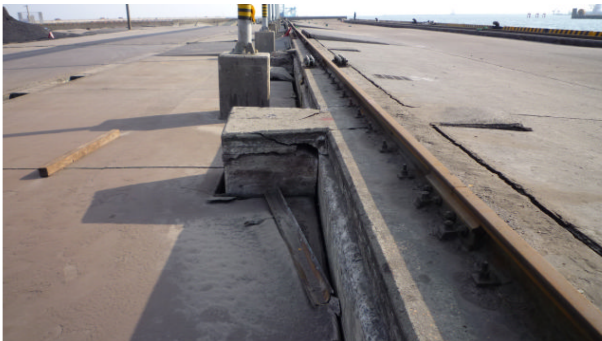
写真 2. 3. 28 相馬港 3号埠頭 石炭用アンローダー設置の鋼矢板式岸壁に生じた段差
