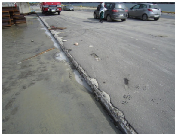
写真 2. 3. 31 高松埠頭岸壁の段差
