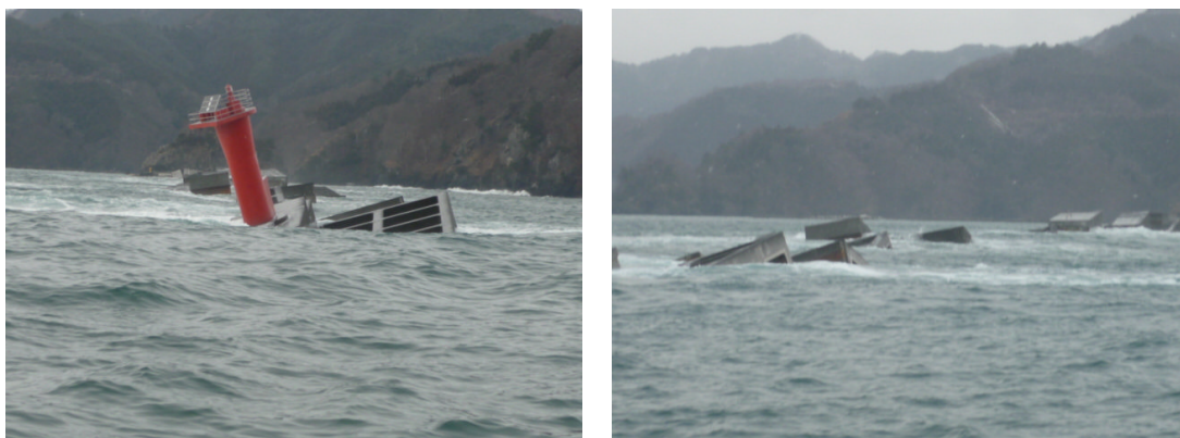
写真 2.3.1 釜石港湾口防波堤の被災状況
