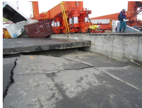
写真 2. 3. 39 高砂埠頭 2 号岸壁エプロン背後の被災状況
