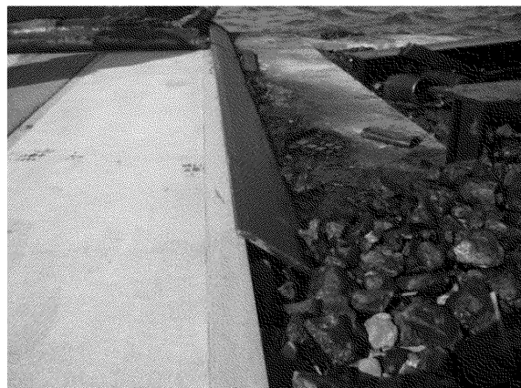
写真2.3.23 背後との段差(15cm程度)
