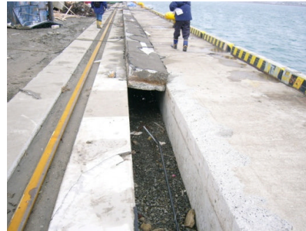
写真 2. 3. 37 高砂埠頭 2 号岸壁に生じた空洞
