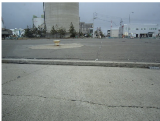
写真 2. 3. 34 中野埠頭エプロンと荷役ヤード境界付近の亀裂
