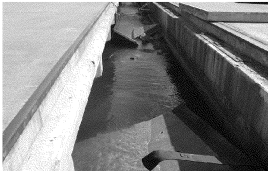
写真 2.3.2 諏訪下地区栈橋（-7.5m） —津波による渡版の被害—
