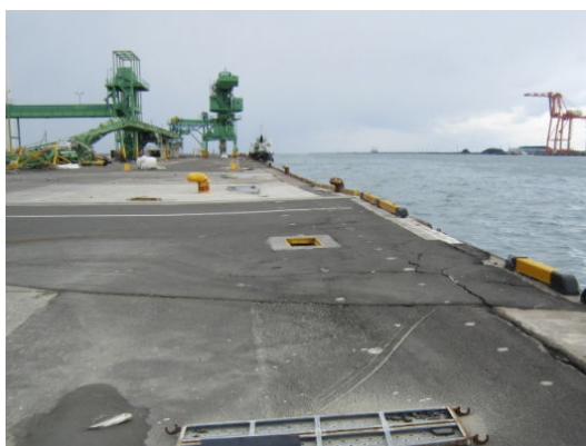
写真 2. 3. 32 中野埠頭 1 号～ 2 号岸壁の小沈下
