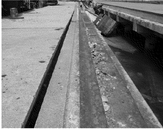
写真 2.3.5 諏訪下地区栈橋(-7.5m) —コンクリート舗装と土留め壁の間の開き—
