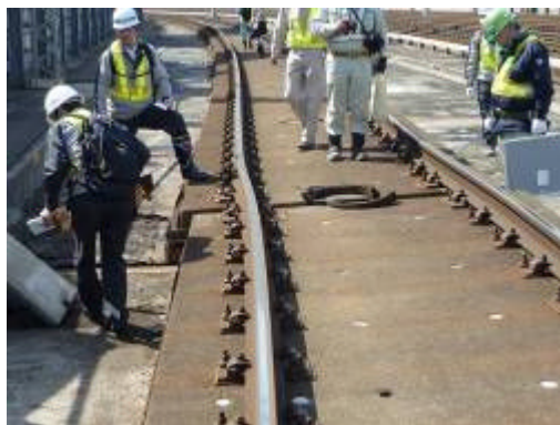
写真 2.2.17 スラブ軌道の変状
