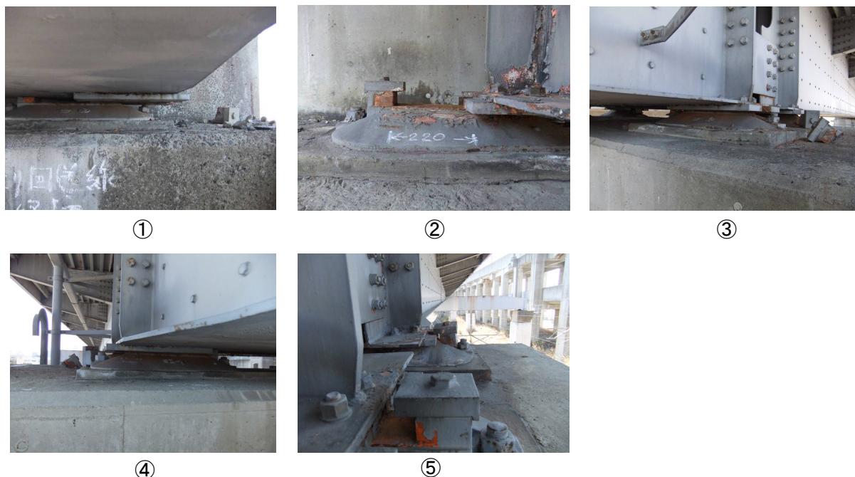
写真 2.2.1 各位置における桁座水平方向のずれ
