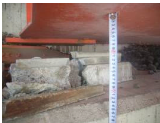
写真 2.2.3 桁座コンクリートの欠損（下り）（②）
