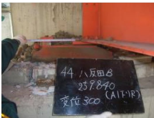
写真 2.2.2 桁座水平方向のずれ（下り）（①）
