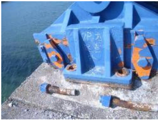
写真 2.2.20 アンカーボルトの抜出し
