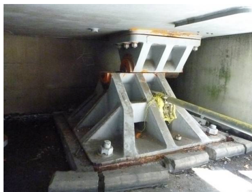
写真 2.2.16 右側支承の損傷
