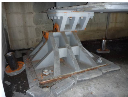
写真 2.2.15 左側支承の損傷
