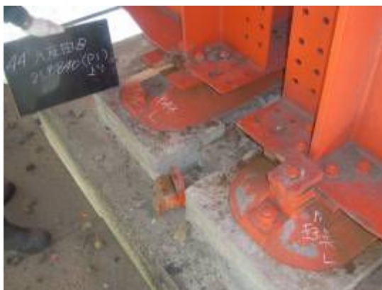
写真 2.2.5 ずれ止めの破損（上り）（④）
