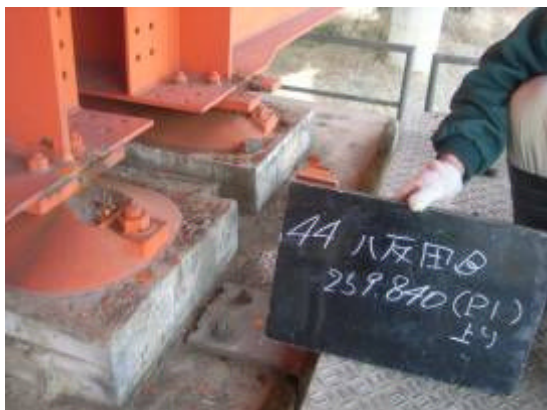
写真 2.2.4 ずれ止めの破損（上り）（③）
