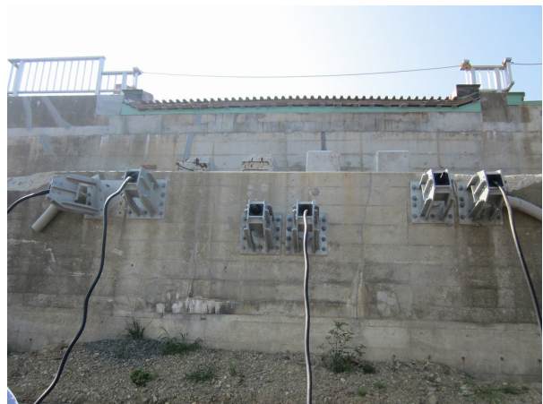
写真 2.1.71 落橋防止構造の損傷 (2011 年 8 月 12 日撮影)
