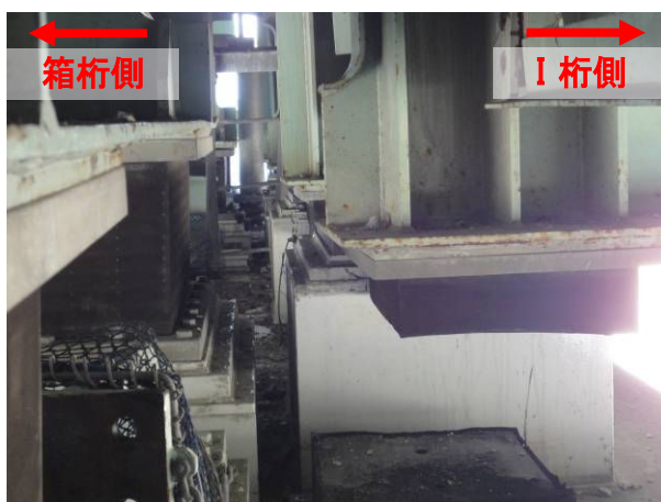
写真 2.1.43 P56 ゴム支承破断状況
