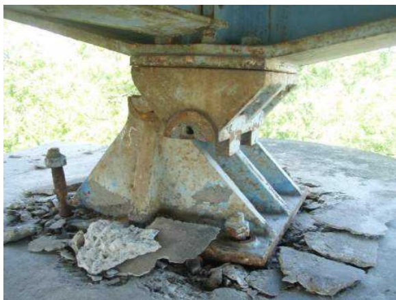
写真 2.1.5 ピン支承の損傷例 2)
