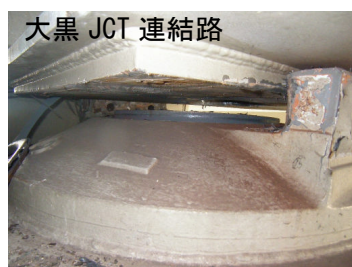
上沓・サイドブロックの損傷
