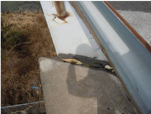
写真 2. 1. 32 桁のずれ状況
