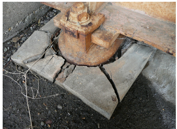
写真 2.1.2 沓座モルタルの損傷例
