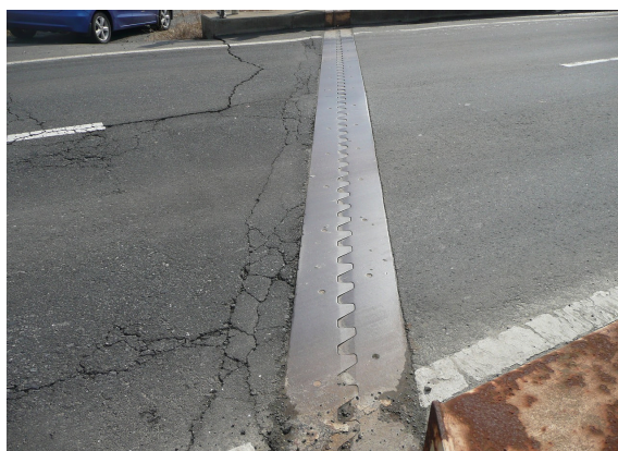
写真 2.1.19 背面土の沈下に伴う遊間異常
