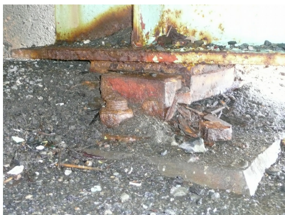
写真 2.1.13 線支承の上沓の腐食と地震による損傷例
