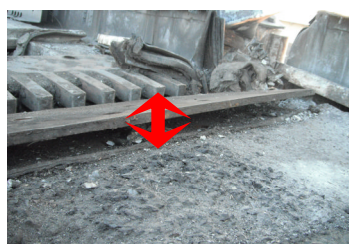
路面に20cm段差(PC23橋脚)
