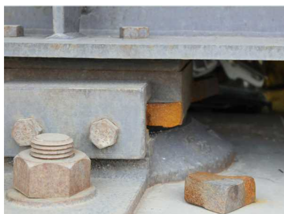
写真 2.1.10 支承板支承の上沓の損傷例 (舘石教授・奥井教授から写真提供)
