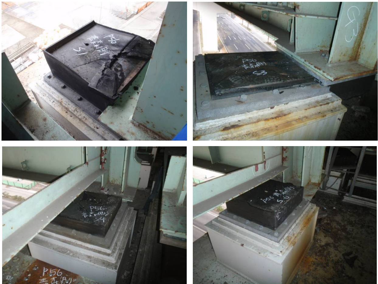
写真 2.1.45 P56 ゴム支承の各破断面の状況
