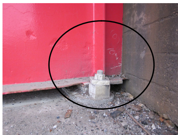
写真 2.1.22 主桁下フランジの局部変形
