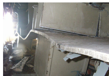
ゲルバー構造上面側主桁の損傷
