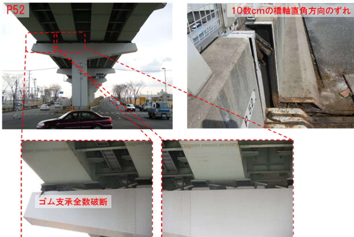
写真 2.1.37 P52（箱桁側）支承部及び路面の被災概況
