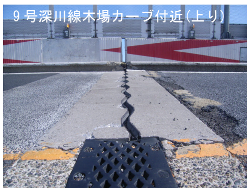
路面の段差・コンクリートの損傷
