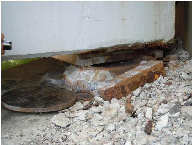
写真 2. 1. 30 BP-B 支承の損傷
