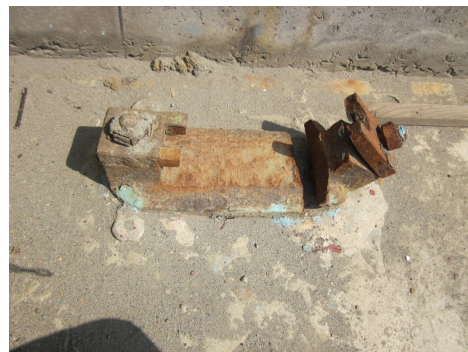
写真 2.1.77 流失した水尻橋と支承の状況 (2011 年 4 月 15 日撮影)
