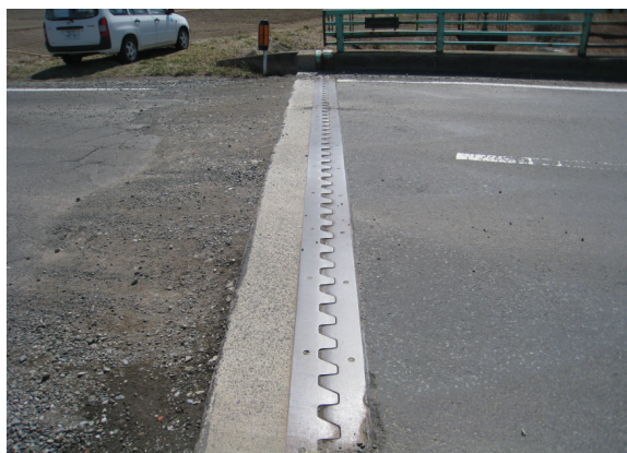
写真 2.1.18 背面土の沈下に伴う遊間異常
