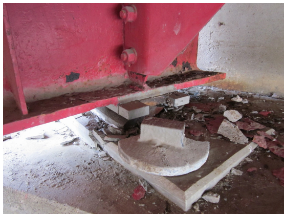
写真 2.1.1 沓座モルタルの損傷例
