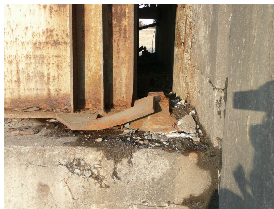
写真 2.1.24 支承からの逸脱でも主桁に 損傷がなかった例
