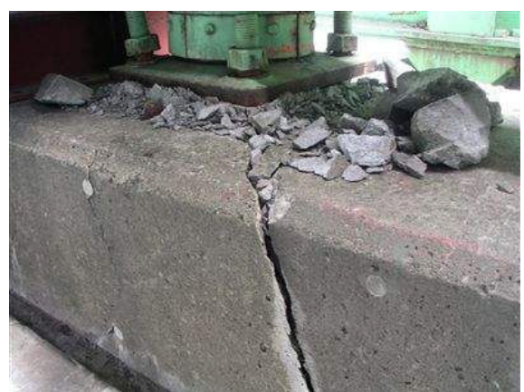
写真 2.1.4 沓座コンクリートの損傷例 2)
