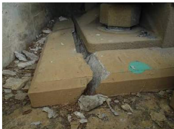
写真 2.1.3 沓座モルタルの損傷例 2)
