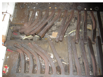
鋼製継手の損傷
