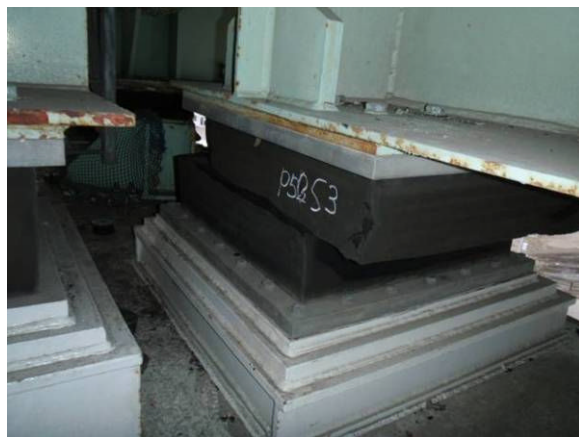
写真 2.1.46 P52 ゴム支承の破断状況
