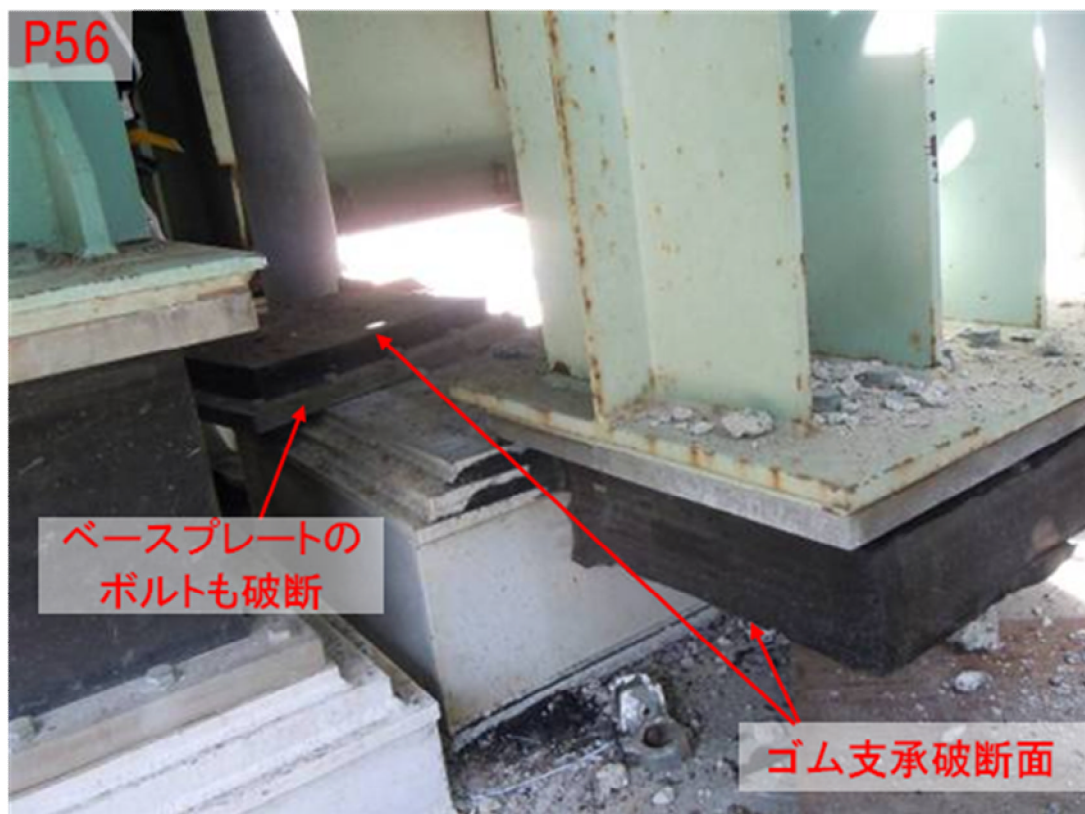
写真 2.1.38 P56（I 桁側）の支承の損傷状況
