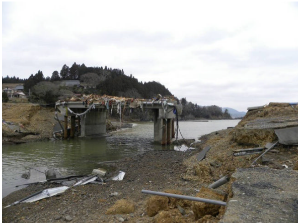
写真2.1.86 橋台背面土が流失した二十一浜橋 2)
