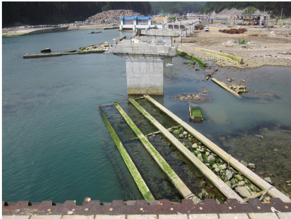
写真 2.1.89 流失した歌津大橋 (2011年8月12日撮影)
