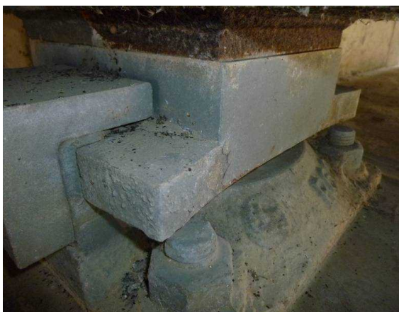
写真 2.1.7 支承板支承(固定)の上沓の損傷例 2)
