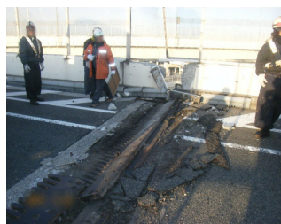
路面損傷状況
