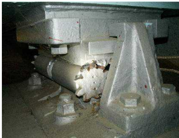
写真 2.1.6 ローラー支承の損傷例 2)
