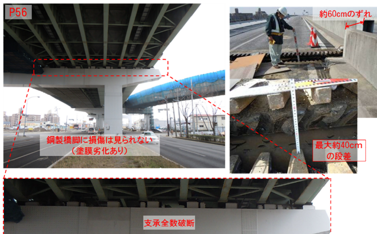
写真 2.1.36 P56（I 桁側）支承部及び路面の被災概況
