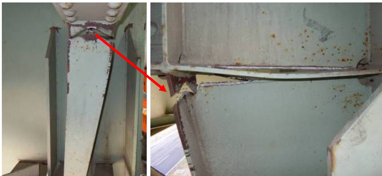
写真 2.1.39 垂直補剛材の損傷状況
