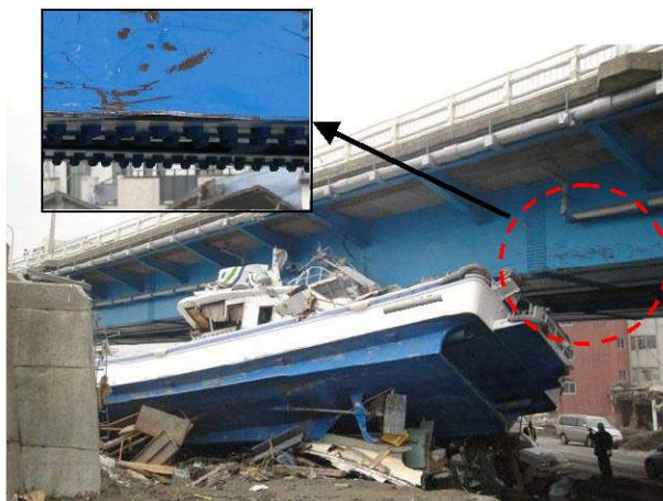
写真 2.1.91 津波で流された船舶による桁の損傷 (国総研から写真提供)
