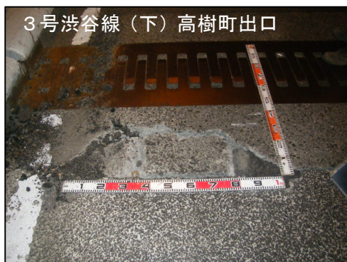
コンクリートの損傷
