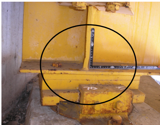
写真 2.1.23 垂直補剛材の局部変形
