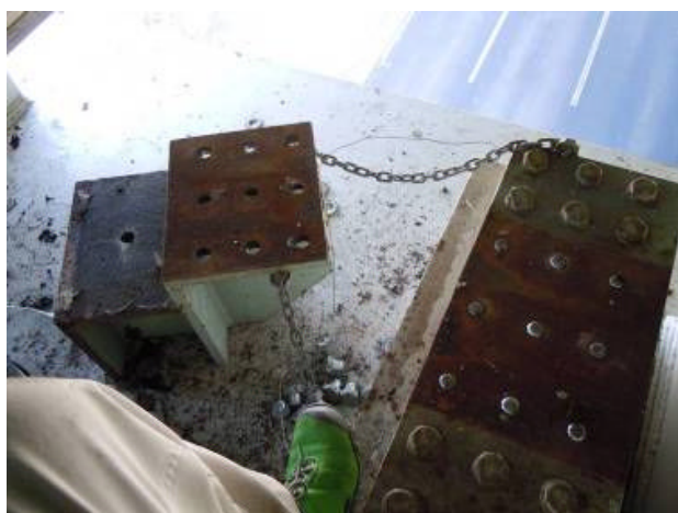
写真 2.1.41 ジョイントプロテクターの 損傷状況
