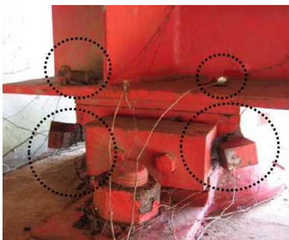
写真 2.1.9 支承板支承の上沓の損傷例 (国総研から写真提供)
