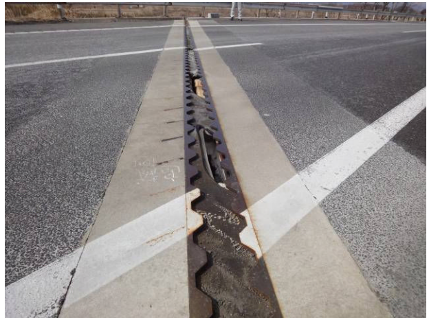
写真 2. 1. 31 伸縮装置の遊間異常
