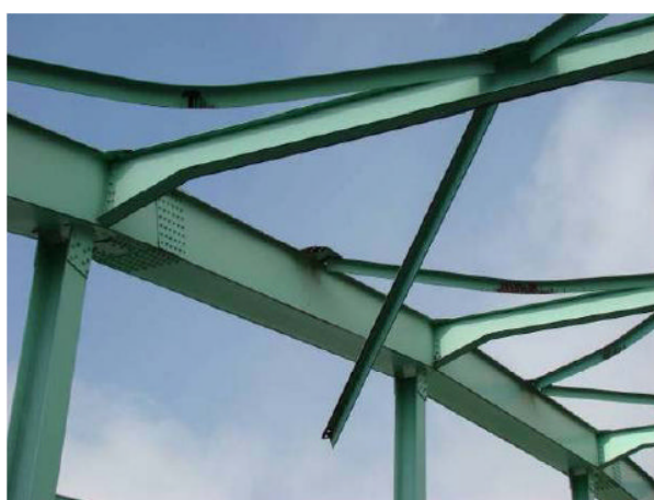
写真 2.1.25 アーチ橋における横構の座屈 およびガセットの破断 (国総研から写真提供)
