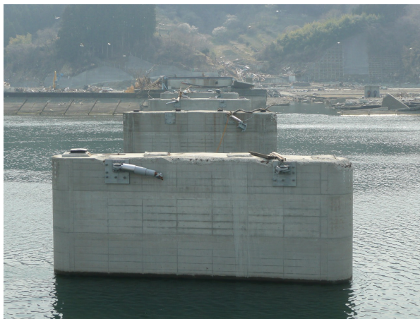
写真 2. 1. 83 残された橋脚と桁端 (2011 年 4 月 14 日撮影)
