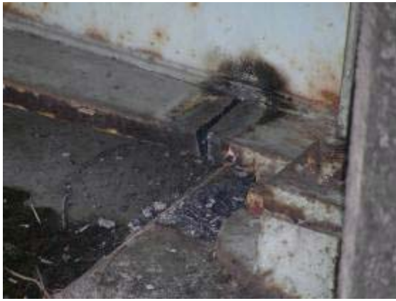
図-3 ガス切断によるスリット (損傷シリーズ 1)
