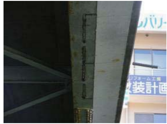
図-4 下フランジの切除 (損傷シリーズ 2)
