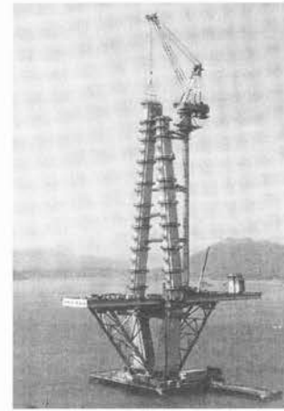
図-3.9 多々羅大橋塔架設
