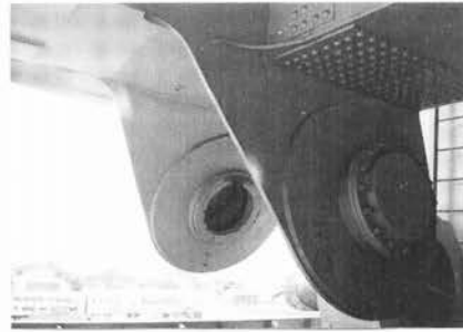
図-2.68 ペンデル支承の損傷 (東神戸大橋 端橋脚)
