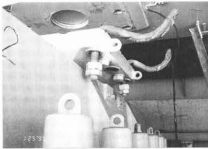
図-2.67 ラテラル支承の損傷 (東神戸大橋 端橋脚)
