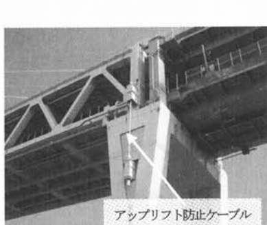
図-2.76 アップリフト防止ケーブル（端橋脚）
