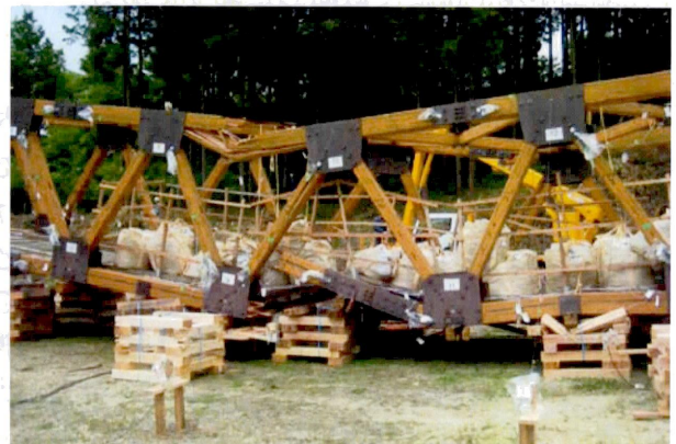
写真7 部材破壊状況（二次破壊）
