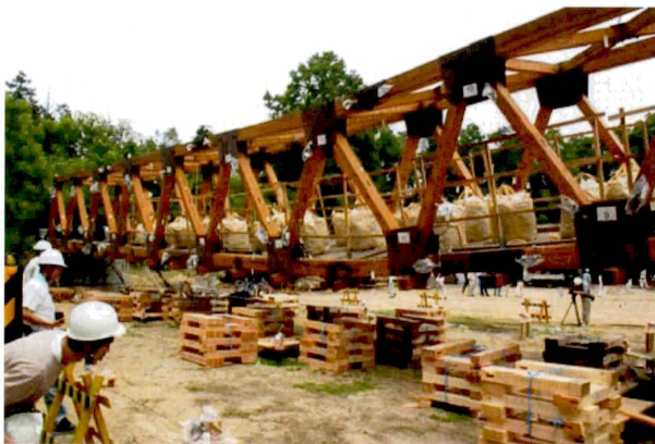
写真4 上流側下弦材の破断により傾ぐ
