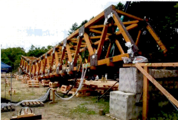
写真6 下流側上弦材の圧壊により着地
