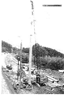
地すべり抑止杭
