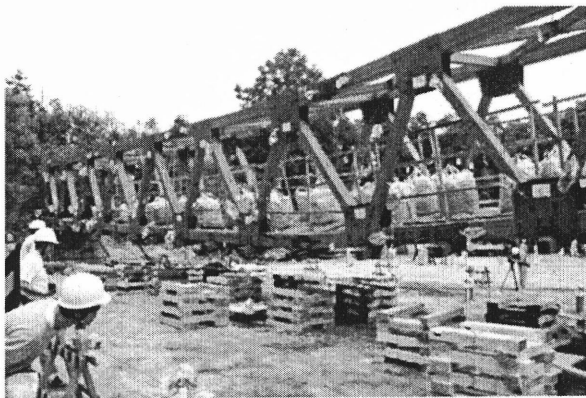
写真4 上流側下弦材の破断により傾ぐ
