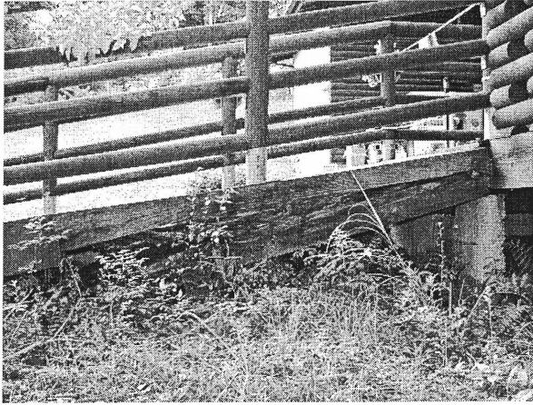
写真-3 劣化を想定していなかった例
