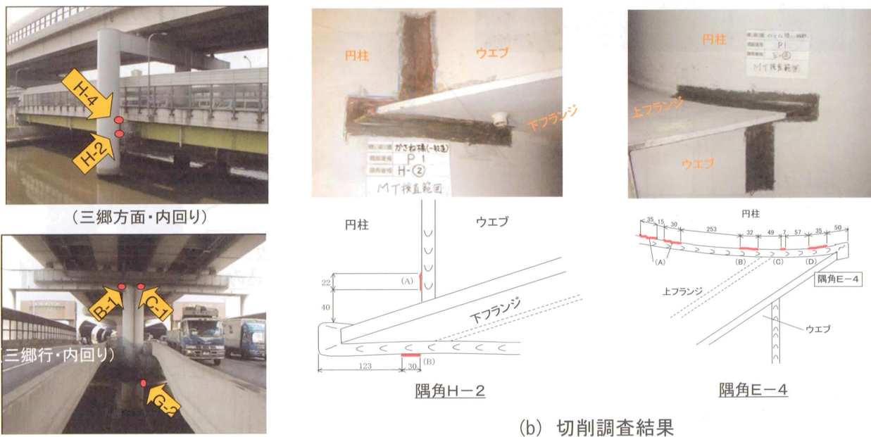
(a) 橋脚全景 (川口側) 矢印: 亀裂箇所
