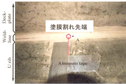
図-16 防食塗装膜下のき裂検出
