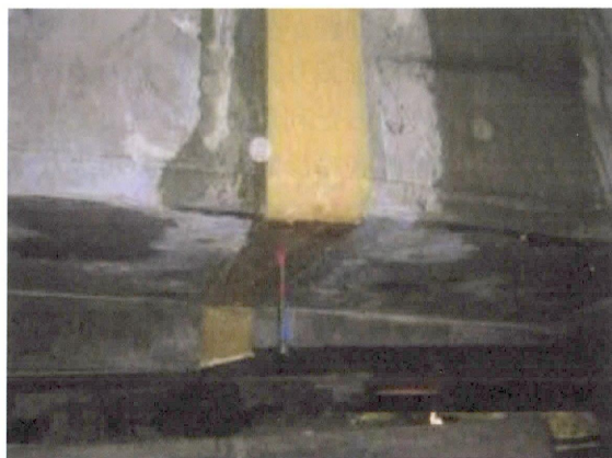
写真－4 ポリブタジエンフォームによる桁遊間の漏水対策
