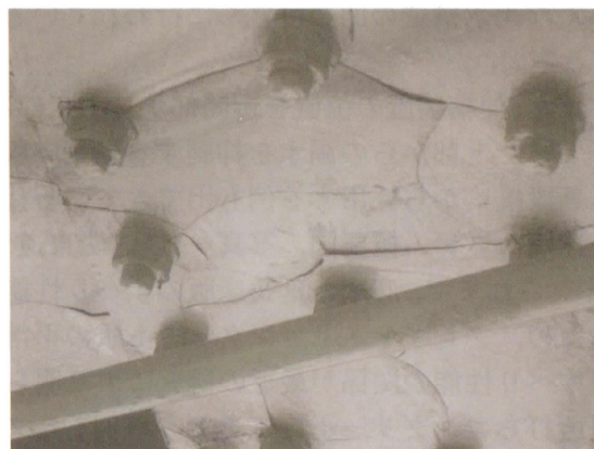
写真－3 塗替え塗装での不具合事例 過膜厚であることや塗重ねた新しい塗料の影響による既存膜の損傷が原因と思われる例。
