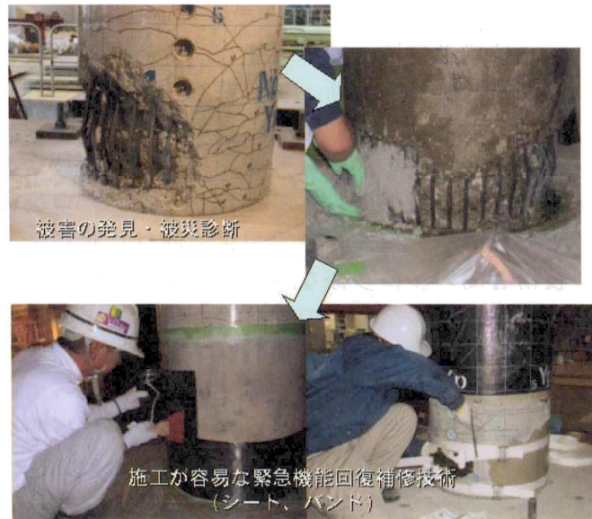
写真-2 地震後の RC 橋脚の早期機能回復技術
