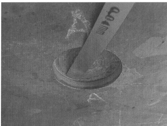
写真-6 隙間ゲージを用いた剥離間隙の測定状況
