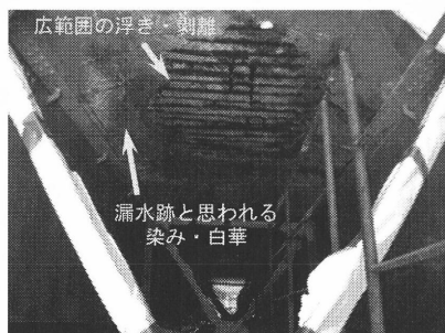
(1) 床版下面の広範囲な浮き・剥離
