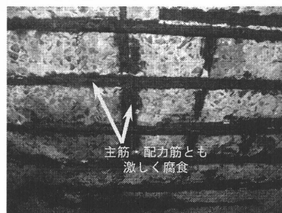
(2) 左図拡大 (主鉄・配力筋の腐食状況)
