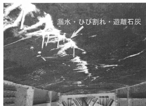
写真-3 漏水・ひび割れ・遊離石灰の状況 (F橋)
