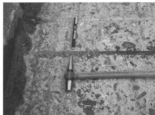
写真-2 路面切削機による上側鉄筋の損傷例
