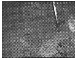
【写真-9】床版上面コンクリートの土砂化(水の存在あり)
