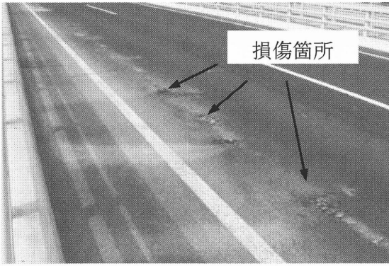
写真-1 橋面損傷状況
