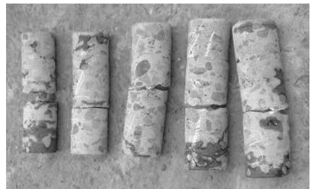
写真-1.2.4 床版コンクリートコア
