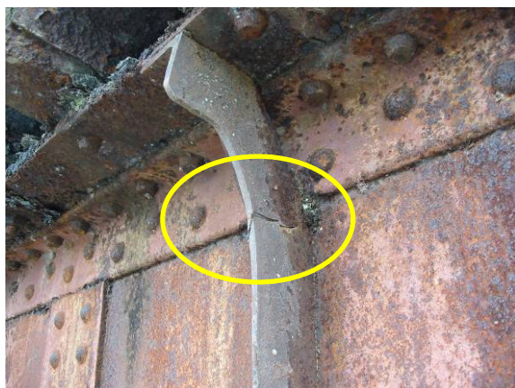
写真-3.2.19 Jスティフナーのき裂
