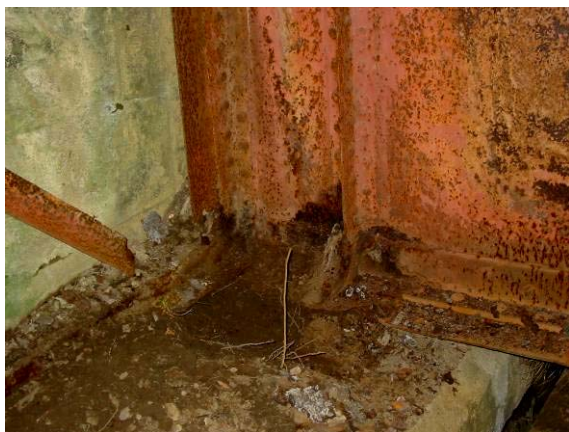
写真-3.2.23 対傾構の欠損
