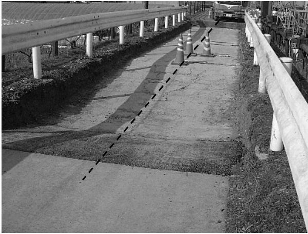
写真-1.2.1 床版陥没部状況（上面）
