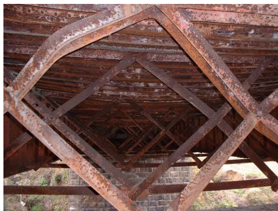
写真-3.2.24 対傾構の座屈
