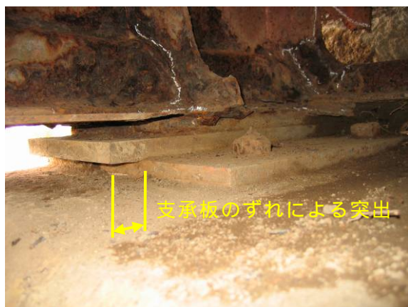
写真-3.2.25 支承板のずれ
