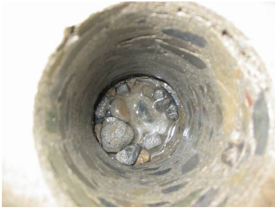
写真-3.2.5 コンクリートの砂利化
