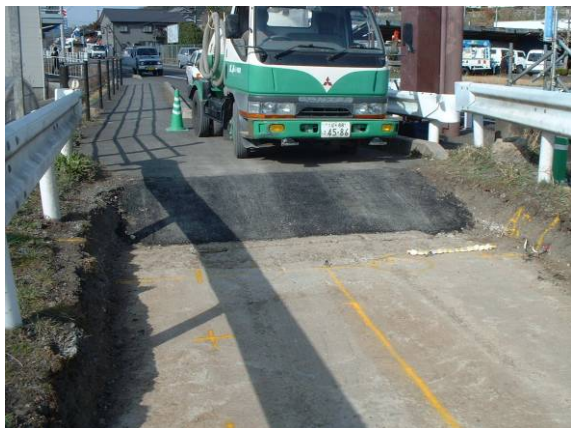
写真-3.2.7 取付道路との段差
