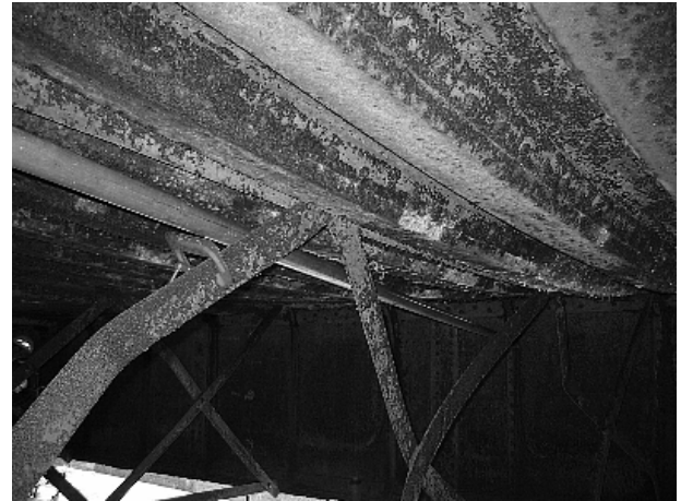
写真-1.2.2 床版陥没部状況（下面）
