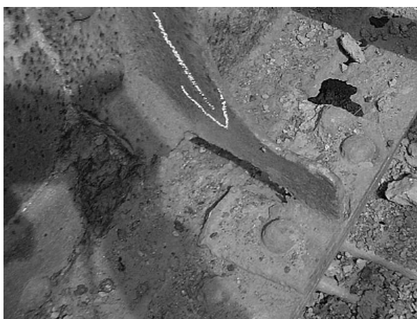
写真-1.2.13 垂直補剛材の腐食状況
