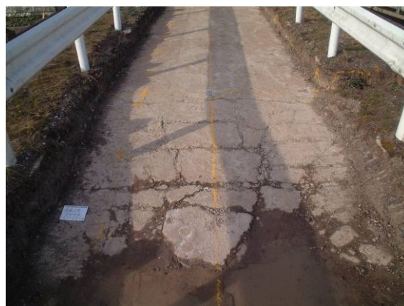
写真-3.2.4 コンクリートのひび割れ
