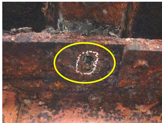
写真-3.2.20 ボルトの脱落
