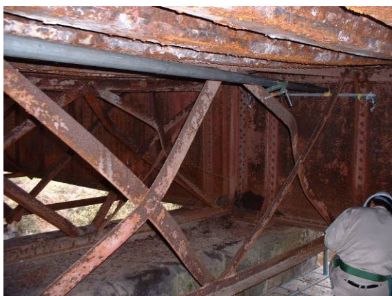
写真-3.2.3 トラフ状底鋼板の変形
