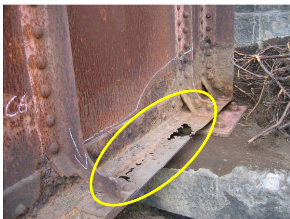
写真-3.2.21 下フランジの欠損
