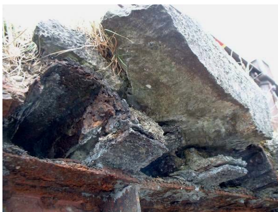
写真-3.2.1 コンクリートのずれ
