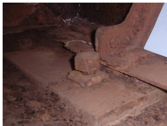
写真-3.2.26 アンカーボルトの浮き
