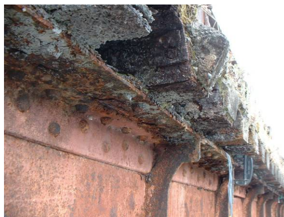
写真-3.2.2 トラフ状底鋼板の腐食
