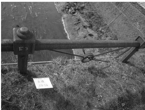
写真-1.2.16 高欄損傷状況
