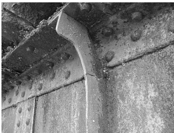
写真-1.2.12 亀裂状況（垂直補剛材）
