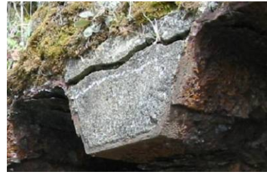
写真 - 3.1.3 トラフ床版のコンクリート ひび割れ
