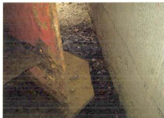
沓座周辺は土砂やじん埃が堆積し，伸縮装置部からの漏水によって，常時湿潤状態となっていることが多い
