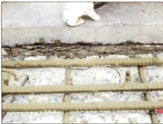
写真 7.25 層状にクラックが入った コンクリート床版
