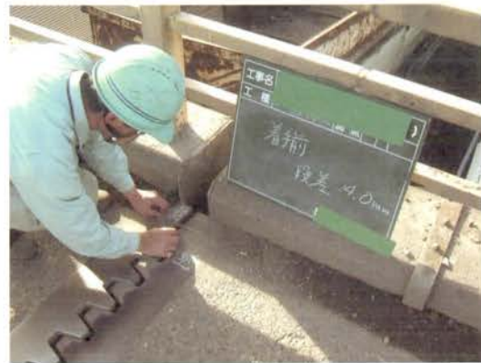
(b) 段差が生じた伸縮装置
