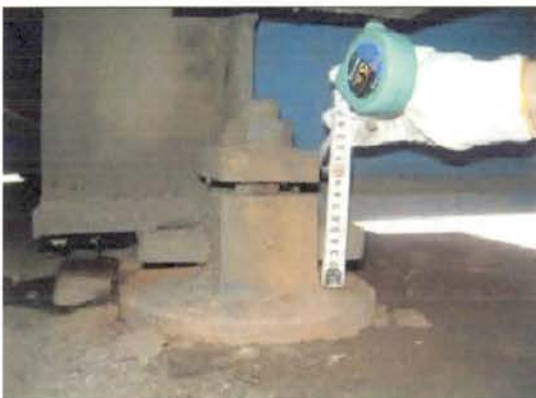
(e) アンカーボルトの浮き
