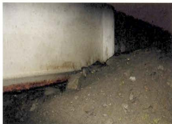
写真 7.12 支承部の土砂堆積
