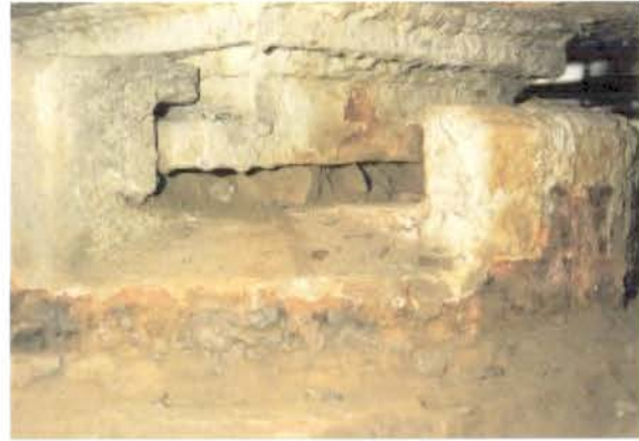
(b) さび・腐食
