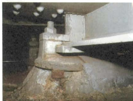
(b) 支承（下沓）の破断による損傷
