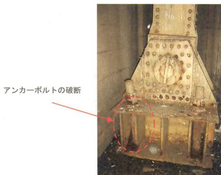
(c) ペンデル支承アンカーボルトの破断
