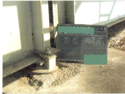
(a) 台座コンクリートの損傷により陥没した支承
