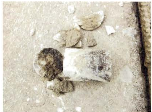
写真 7.26 層状にはく離れたコンクリートコア
