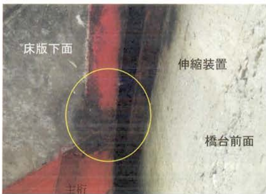
伸縮装置からの漏水によって，主桁フランジに腐食が生じている
