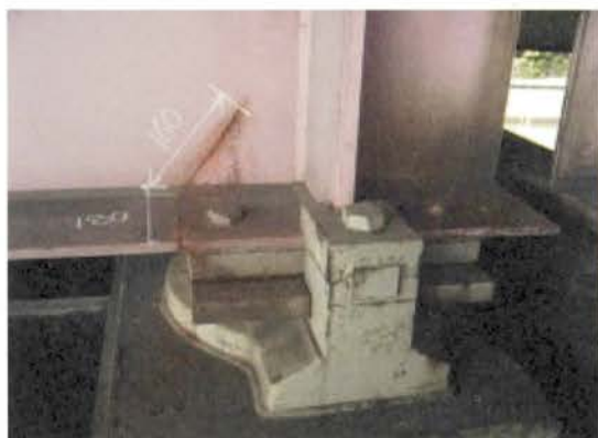
(a) ソールプレート付近からの疲労き裂
