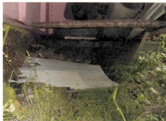
写真 7.13 支承部へのゴミの投棄
