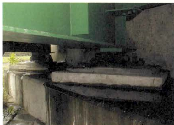
写真 7.11 支承部の滞水
