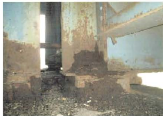
(f) 支承周辺の土砂の堆積
