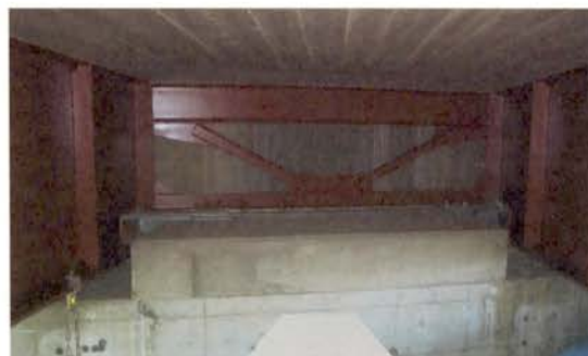
写真 7.22 支承部の作業環境が低下した例
