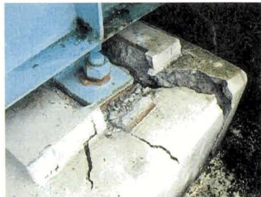
(d) 沓座の損傷
