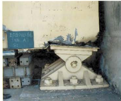
(b) 鉋桁の損傷
