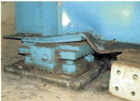
(a) 鉋桁の損傷
