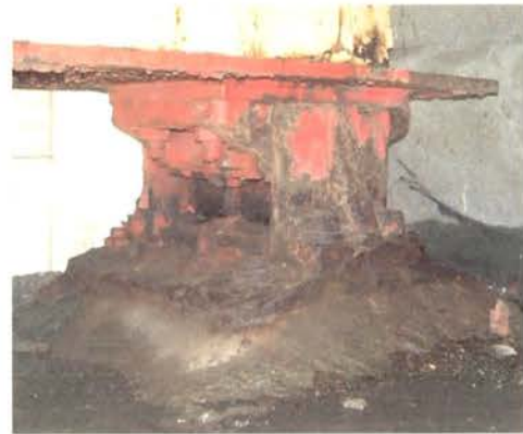
写真 3.15 一本ローラー支承の腐食
