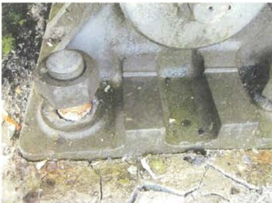
写真 3.36 アンカーボルトの損傷
