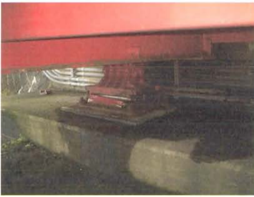
写真 3.50 可動支承の損傷
