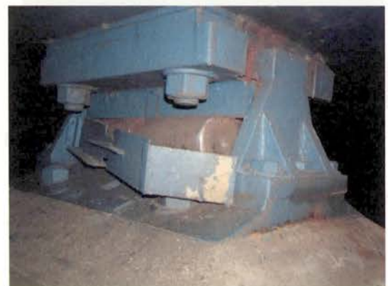
写真3.8 一本ローラー支承のローラーの逸脱
