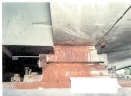
写真3.2 支承本体の腐食
