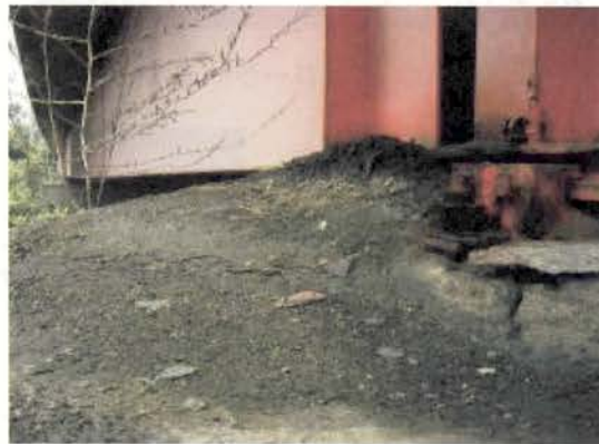
写真 3.18 支承付近の土砂堆積
