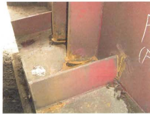
写真 3.53 補剛材の溶接部の破断
