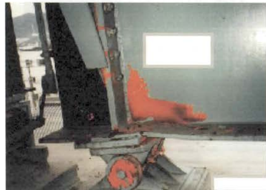
写真 3.47 支点上ウェブの局部座屈
