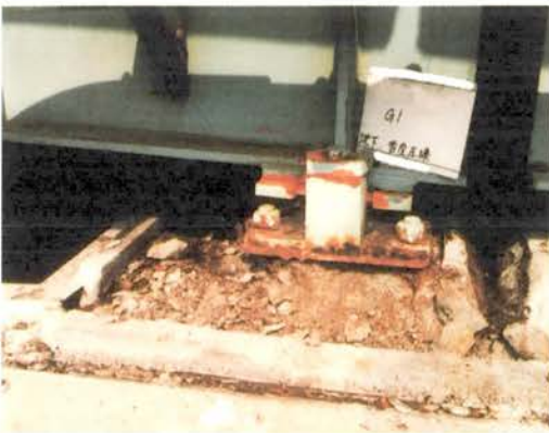
写真 3.43 沓座モルタルの破壊
