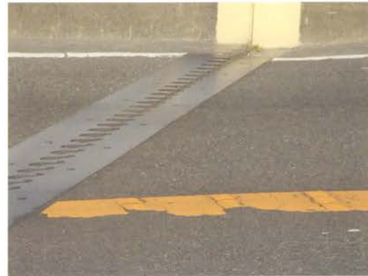
写真 3.60 伸縮装置の段差
