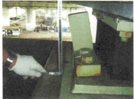
写真 3.39 サイドブロックの変形
