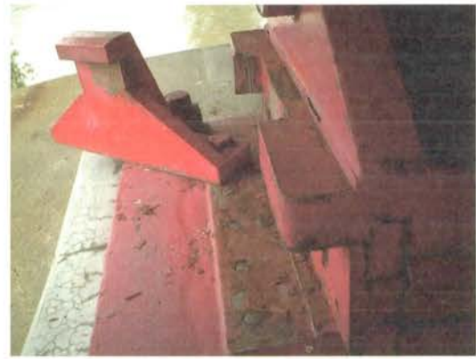
写真3.51 支承サイドブロックの損傷
