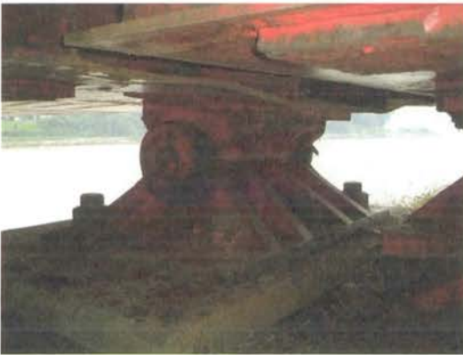
写真 3.52 箱桁下フランジの変形
