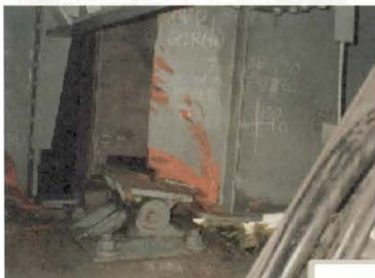
写真 3.48 支点部付近の主桁の損傷
