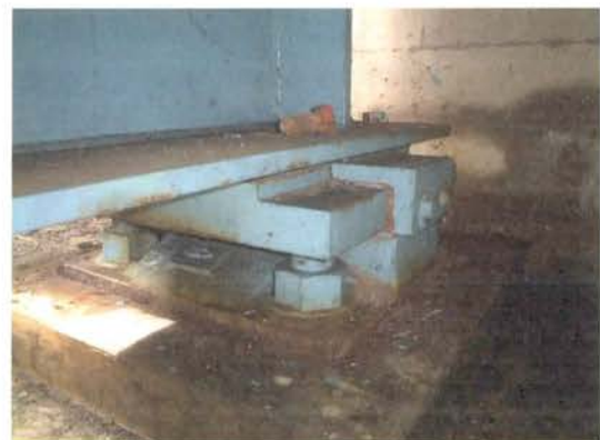
写真 3.37 セットボルトの破断
