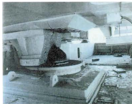
写真 3.31 ピボット支承上沓の割れ
