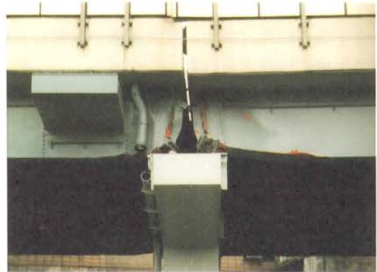
写真 3.45 桁端部における主桁の変形
