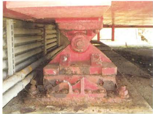
写真 3.35 サイドブロックの破断
