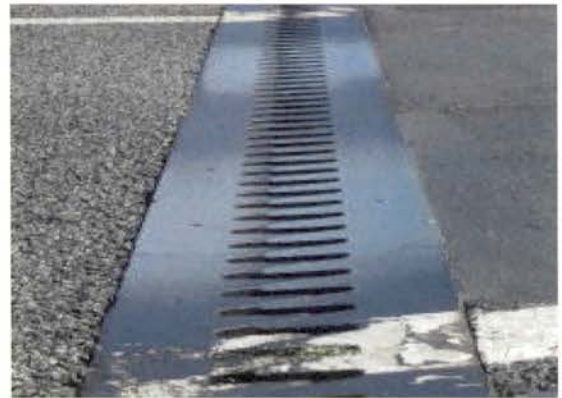
写真3.7 伸縮装置部の段差
