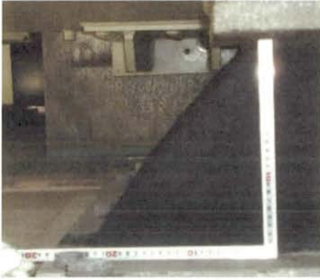
写真 3.41 ゴム支承の変形
