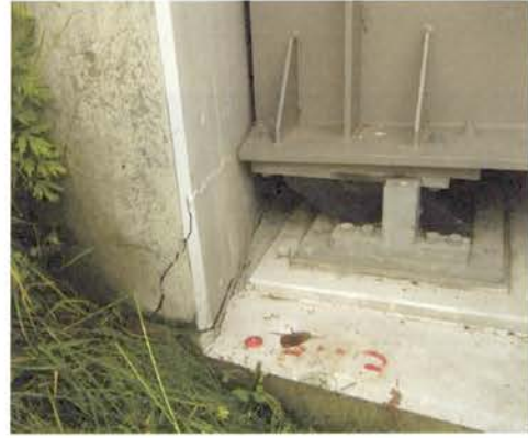
写真 3.42 橋台部への衝突
