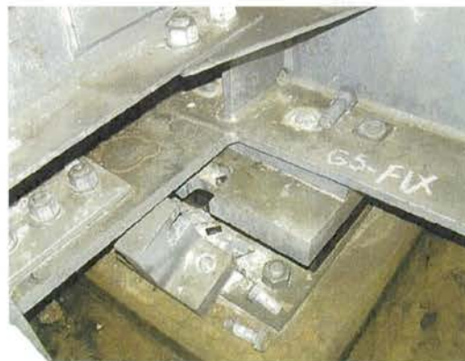
写真 3.40 ボルトの損傷
