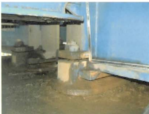
写真 3.12 沈下によるアンカーボルトの緩み
