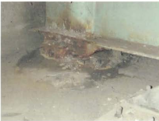
写真 3.14 BP・A 支承の腐食
