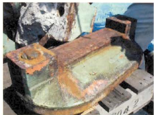
写真 3.19 線支承の腐食
