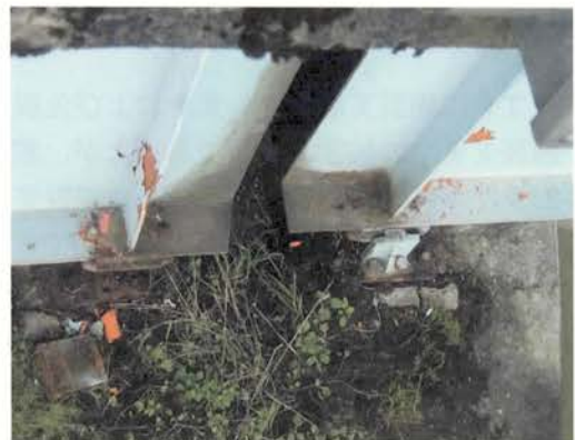
写真3.56 支点上垂直補剛材の座屈
