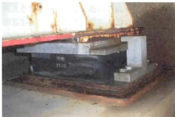
写真 3.27 漏水による鋼材部の腐食
