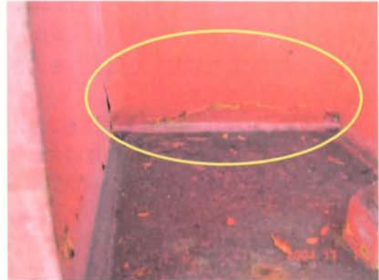
写真3.54 支点上の主桁ウェブ面のはらみ
