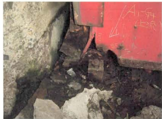
写真3.55 A1橋台上主桁の損傷
