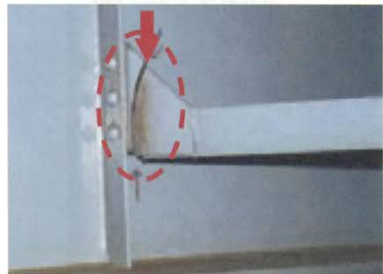
写真 3.57 ガセットプレートのき裂
