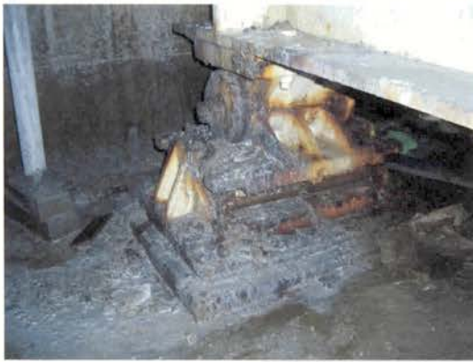
写真 3.16 伸縮装置部からの漏水による腐食
