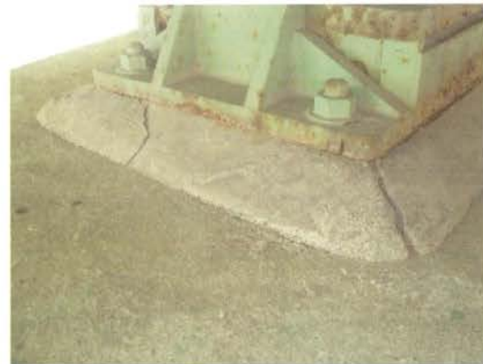
写真 3.29 沓座の割れ、すき
