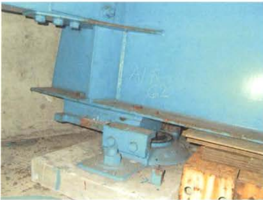
写真 3.34 上沓ストッパーの破断
