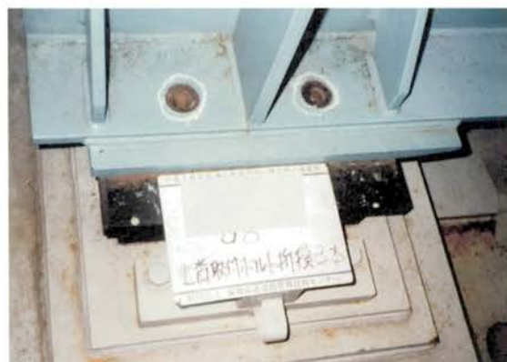
写真3.3 セットボルトの破断
