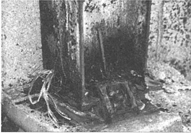
(5) 支柱基部の腐食・断面欠損
