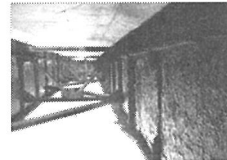
海岸部近傍の鋼桁の損傷
