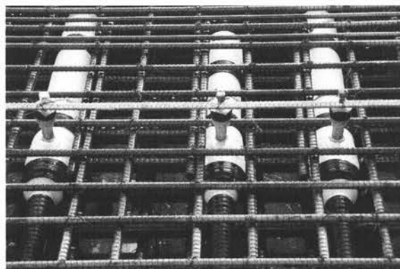
写真-7.2.27 グラウト用ゴム製治具
