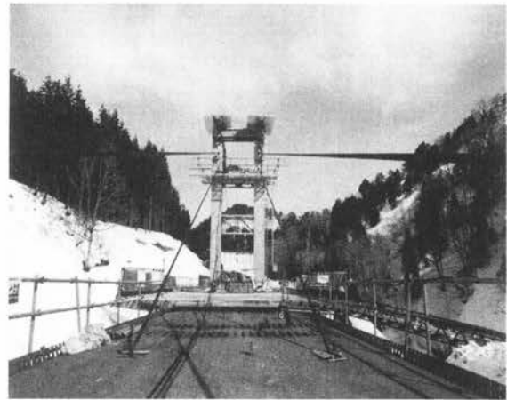
写真-2.5.9 手延べ斜吊り併用押し工法の架設ケーブル配置状況
