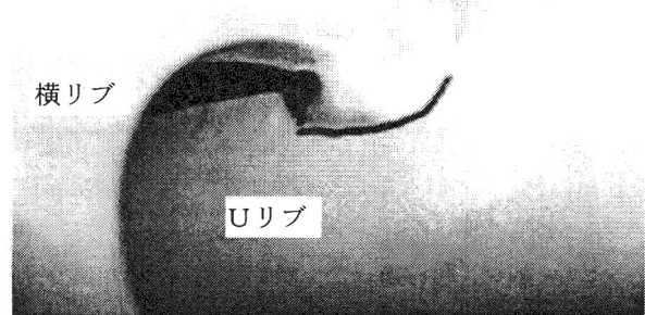
写真-5 横リブとの交差部におけるUリブ母材のき裂(モード④-a)
