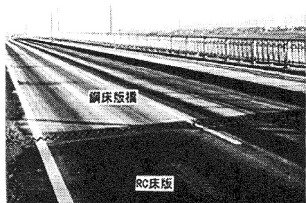
写真1 鋼床版橋とRC床版橋の結露凍結の違い
