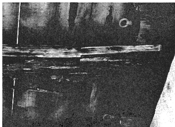
写真-2 木橋に見られる腐朽の例
