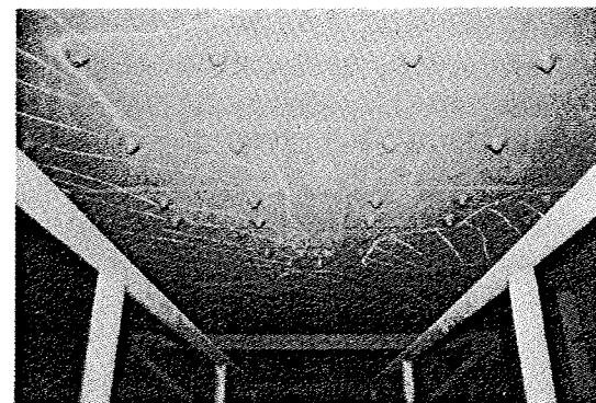
写真-2.2.7 鋼板はく離（不良音箇所の分布の一例）
