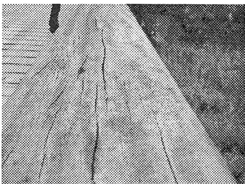
写真-6 高覧のひび割れとかび
