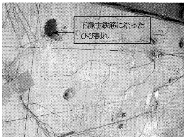
写真-4 床版下面の破壊状況
