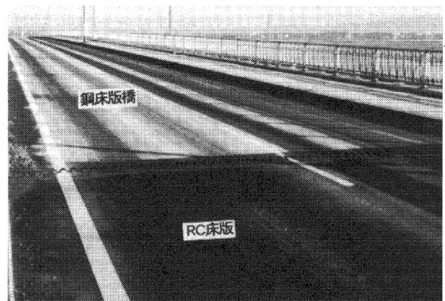
写真-1 鋼床版橋とRC床版の結露凍結の違い
