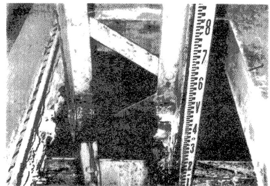
写真—5 トラス斜材の コンクリート埋め込み部の腐食
