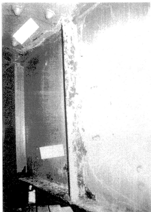
写真-2 床版損傷部からの漏水による主桁の腐食
