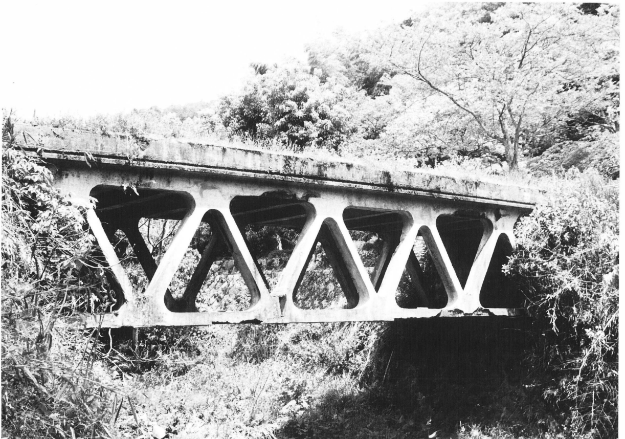
廃道になり、荒れるにまかされている。
