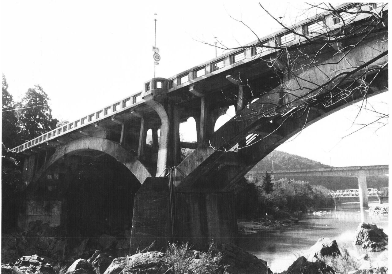
河中の岩から立ち上る橋脚にもコンクリートが打ち足されている。
