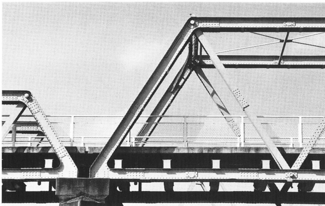
右のトラスの斜材の継ぎ目と下弦材のピン穴カバーに注目
