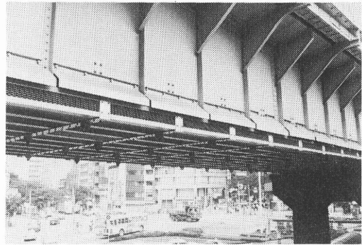
写真-2.16 鳩害防止のために桁下を遮蔽した例
