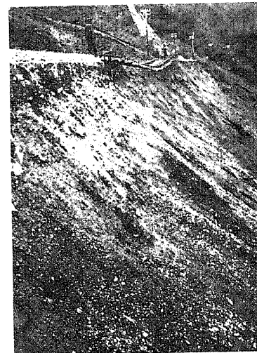
図-26. 線路築堤流失の状況
