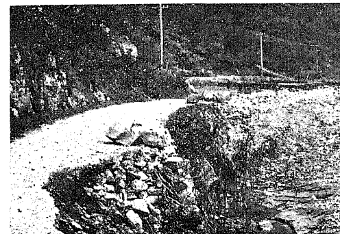
27. 道路及田畑流失（國道 19 號線）
