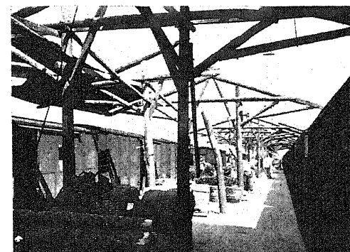
図-73. 梅小路驛貨物中継上家破損状況
